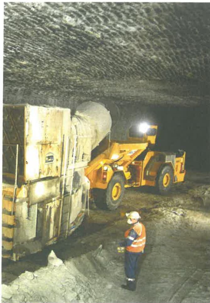
Die Stromkabel werden in der Gegend um Heilbronn unter Tage verlegt. Foto: dpa/Südsalz GmbH
